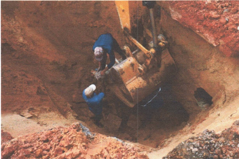
Buraco na Avenida Jerônimo de Albuquerque está sendo recuperado por equipes da Caema e da Prefeitura de São Luís
